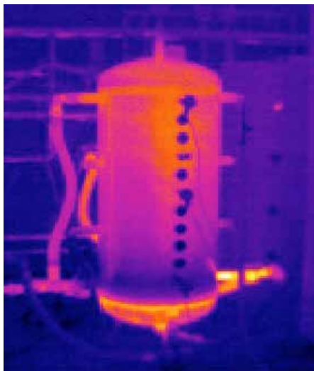
Solar térmico MT Solar heat MT
