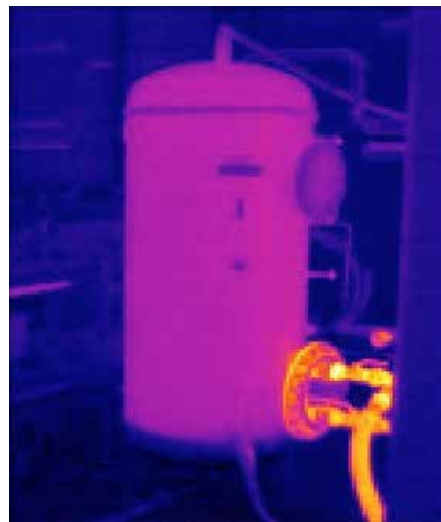
SOLAR TÉRMICO CALDERA COMÚN Solar heat COMMON TANK
